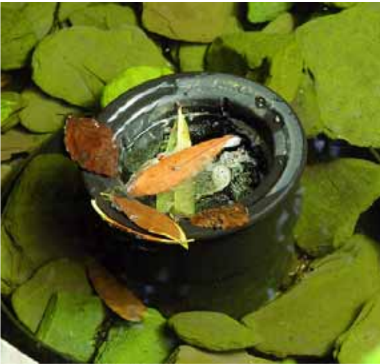
Overfladeskimmer i plast i perfekt funktion.
